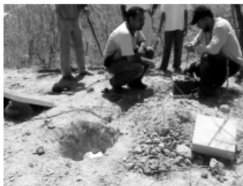
Instalación de estación sísmica en Coluta, Durango
