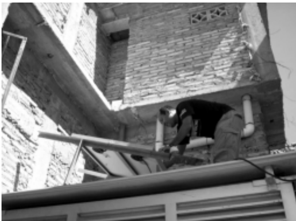
Red de atenuación, mantenimiento
