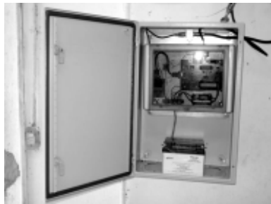
Aspecto del nuevo gabinete de la estación repetidora Mactumactzá
