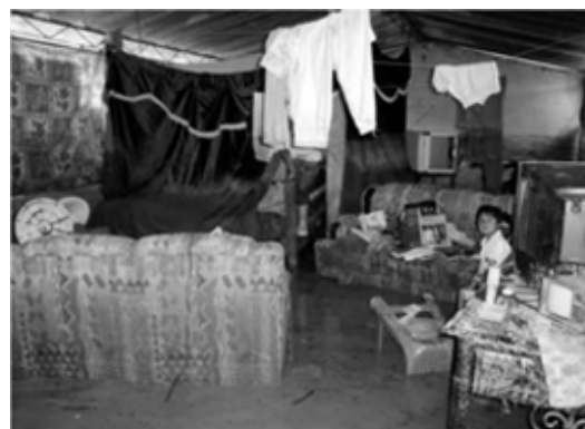
Daños en una vivienda a consecuencia del huracán Dean en el estado de Veracruz. Fuente: 2006 Wildcoast/Costasalvaje
