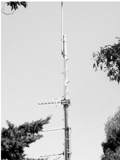
Acondicionamiento de antenas para enlaces de comunicación
