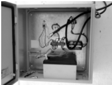
Vista del anterior gabinete de la estación repetidora Mactumactzá
