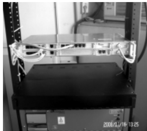
Switch central para la red datos del centro infraestructura de enlace redundante de 2MB
