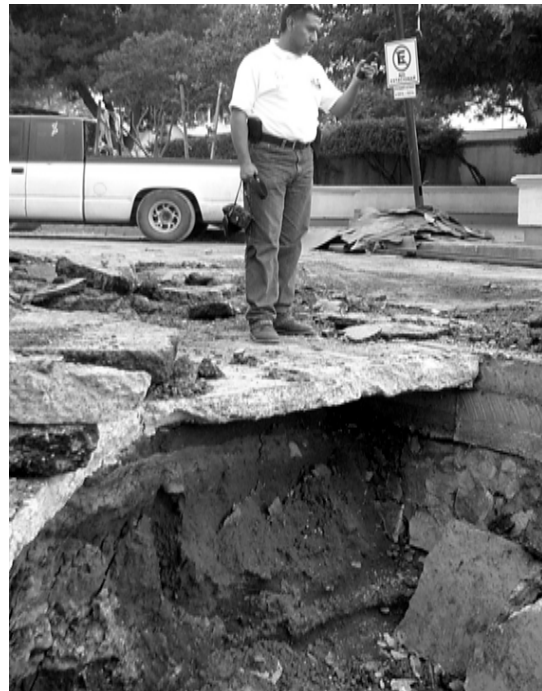
Asentamiento de Terreno. Nogales, Sonora.
